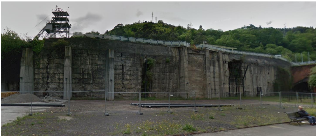
Figura 21. Estado del muro noroeste del pozo Barredo. Fuente: Google Street View.
